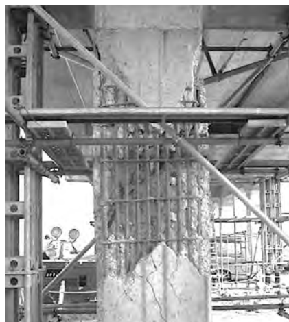
写真-3 三陸南地震による第3愛宕高架橋の端部柱上部の損傷 7)
