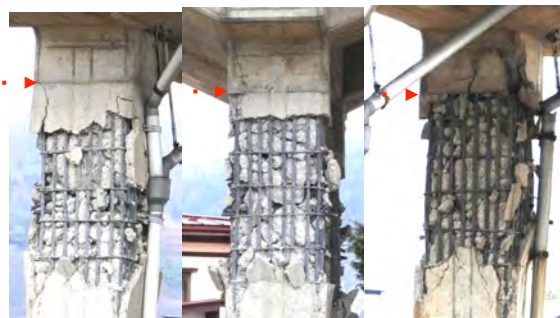
写真-5 柱上部の損傷と打継ぎ目位置（矢印）の関係
