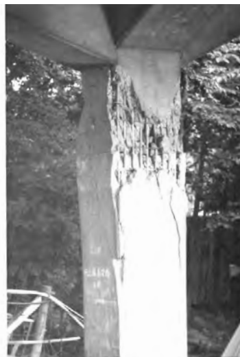
写真-2 宮城県沖地震による行人塚高架橋のRC柱上部の損傷
