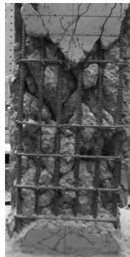
写真-9 Cmix2のコアコンクリート損傷状況
