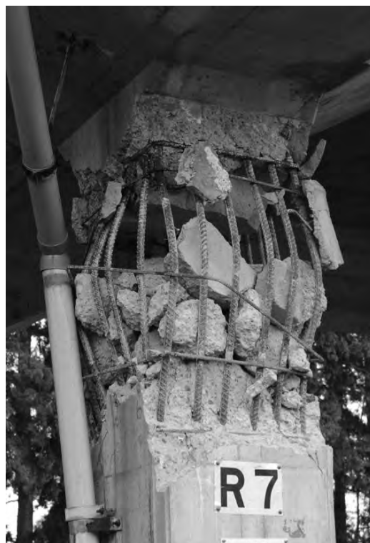
写真-1 第1中曽根高架橋の端部柱上部の損傷
