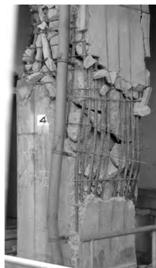
写真-4 新潟県中越地震による第3和南津高架橋の端部柱上部の損傷
