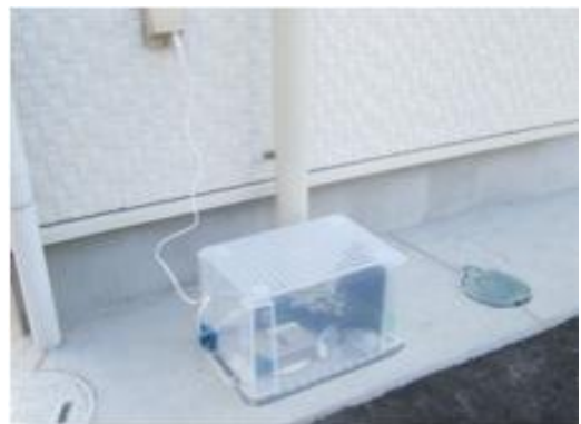
図-3 地震計の設置状況例（F07）。
