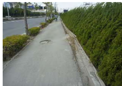
写真-14 歩道の盛り上がり
