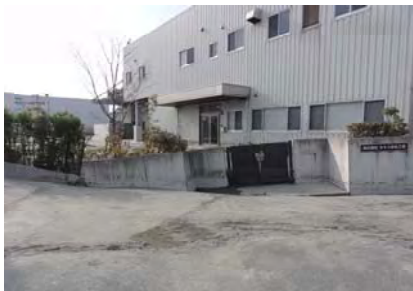
写真-13 門，塀の傾斜，大量の噴砂
