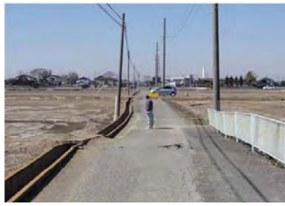
写真-20 道路の沈下
