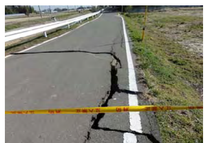
写真-30 道路の亀裂, 段差
