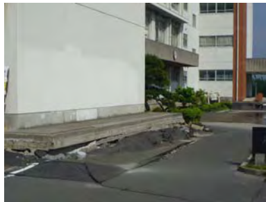
写真-11 大型構造物周辺の沈下
