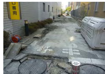
写真-6 外構ブロックの座屈, 大量の噴砂
