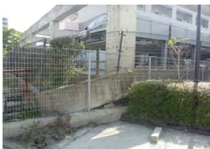
写真-2 駐車場周囲の地盤沈下
