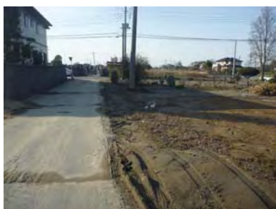
写真-28 噴砂と道路の亀裂・沈下・変形
