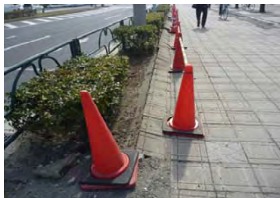
写真-5 歩道ブロックの座屈
