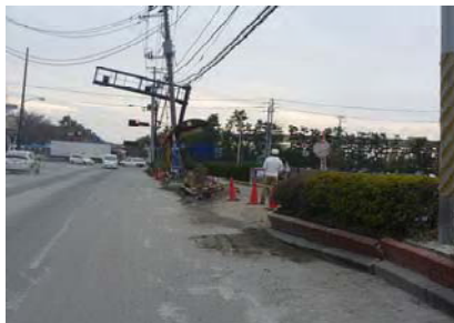
写真-10 道路標識・電柱等の傾斜，歩道の傾斜
