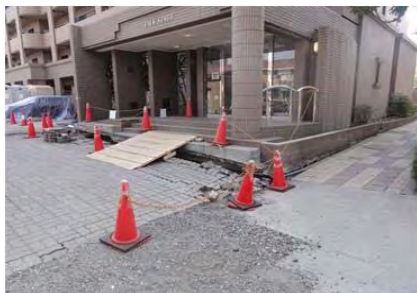
写真-1 建物周囲の地盤の沈下
