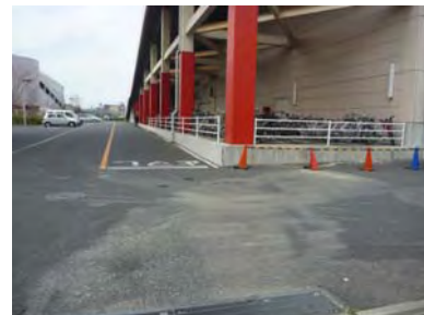
写真-9 東葛西の液状化(建物周囲の沈下)
