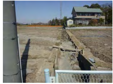
写真-21 民家の変形, 水路の 変形, 噴砂の堆積
