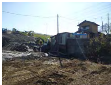
写真-17 法先の民家の変形、埋設管浮上
