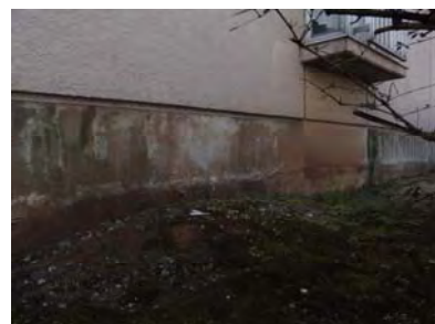
写真-31 越谷市千間台の集合住宅沈下が進行
