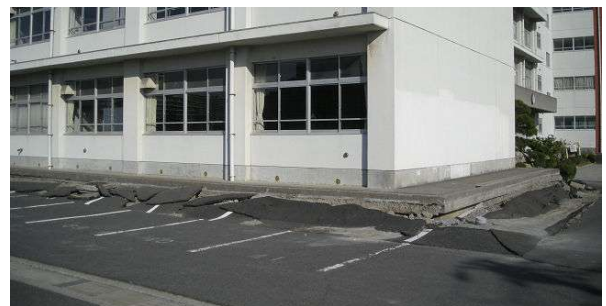
写真-1 液状化による地盤沈下の様子(浦安南高校)
