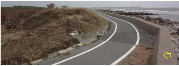
写真-40 河口で途切れた盛土の端部の侵食4/23：西足洗
