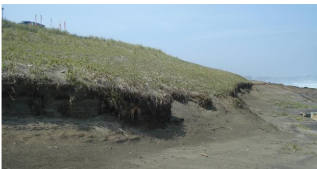
写真-50 津波により侵食された植生帯
