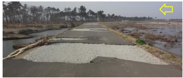
写真-3 津波後の新設堤防の天端 4/30：事例1
