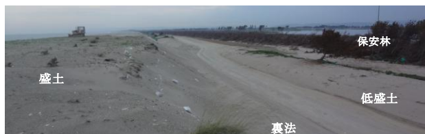
写真-17 盛土の裏法と背後 7/9：事例4
