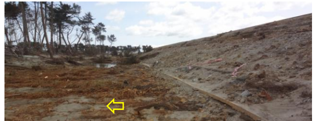
写真-4 津波後の新設堤防の裏法 4/30：事例1
