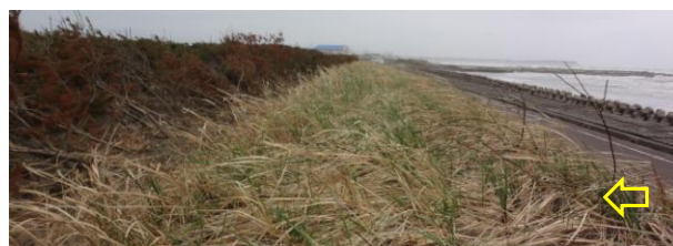
写真-36 津波(低越流)を受けた盛土天端4/23：足川浜（東）
