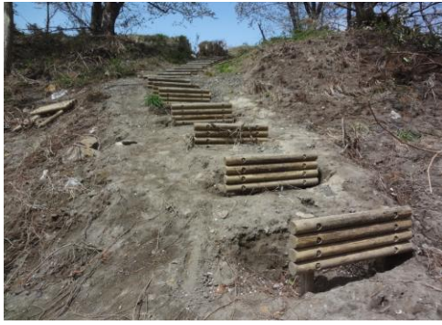
写真-27 写真-26の一角の階段の侵食状況 52：事例6
