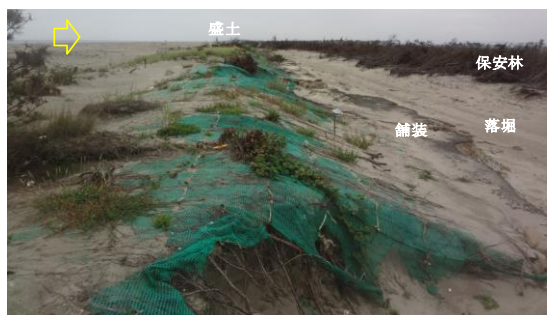
写真-20 低盛土の侵食，落堀の形成 9/11：事例5
