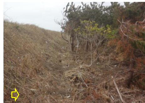
写真-44 津波(低越流)による軽微な裏法尻侵食4/23：三川
