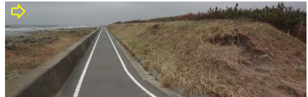
写真-43 津波(低越流)を受けた盛土の表法面4/23：三川
