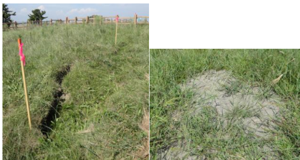
写真-34 南側法面のクラック 写真-35 噴砂跡9/12：事例9
