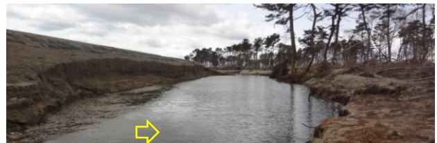
写真-5 裏法尻での落堀の形成と法面の欠落 4/30：事例1
