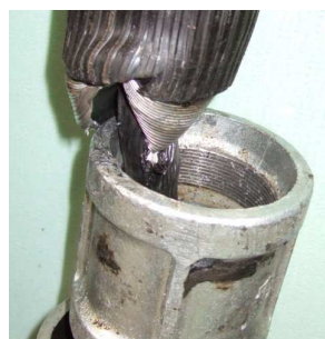
写真-3 屈曲SA管の状況
