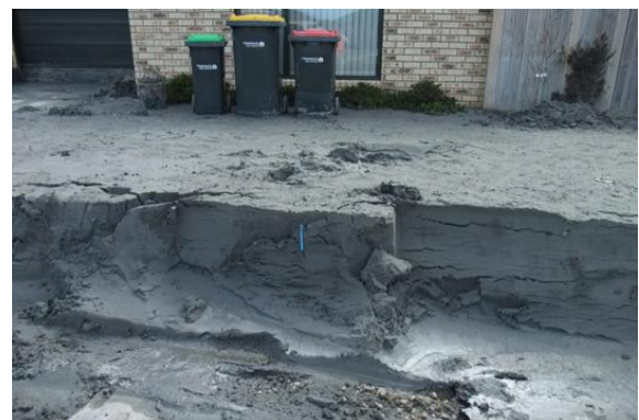
図-6 Christchurch での噴砂の状況（余震）
