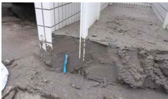
図-2 浦安市で確認した噴砂の堆積状況
