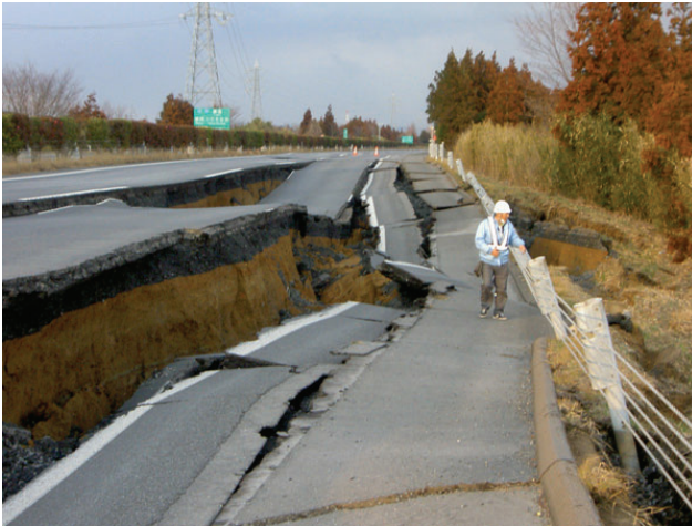
写真-1 検討対象地点での被災状況 1)
