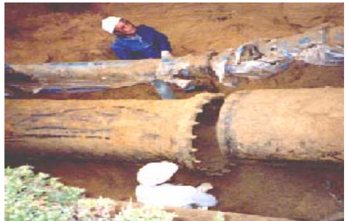
写真-1 ダクタイル鋳鉄管のK形継手抜け出し状況 (神戸市水道局 提供)
