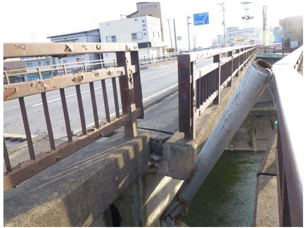
写真-2 錦橋の被害
