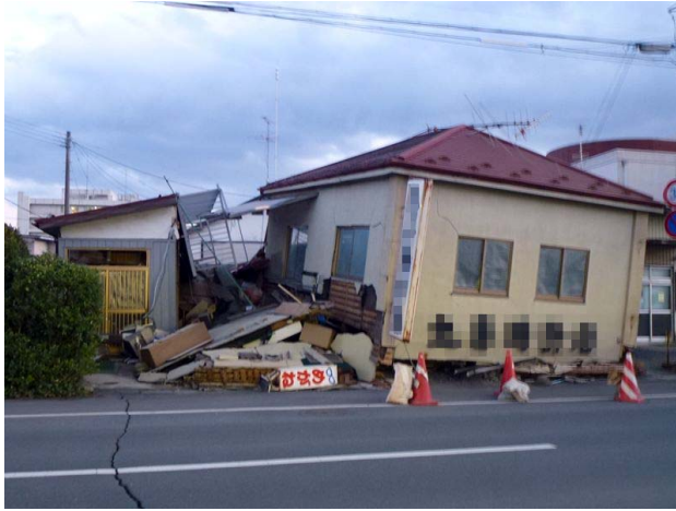
写真-1 小金丁地区の家屋被害
