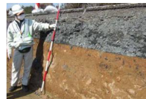
写真-13 崩壊部の道路舗装の様子
