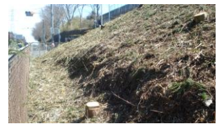
写真-9 のり尻の迫り出し (3/27)
