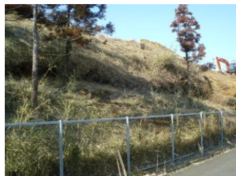
写真-4 法面の迫り出し (3/12)
