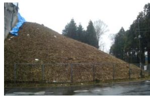
写真-8 取付け盛土の変状 (4/9)
