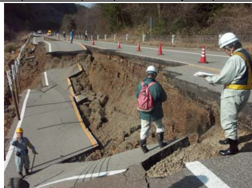
写真-1 盛土崩落状況(6.3km 地点) 4)
