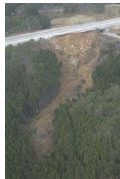
写真-3 崩落土の状況(14.7km 地点) 4)
