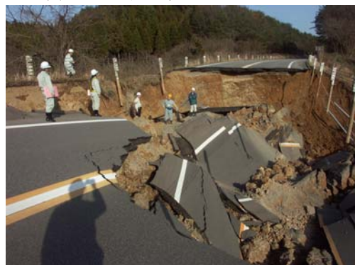
写真-2 盛土崩落状況(11.7km 地点) 4)
