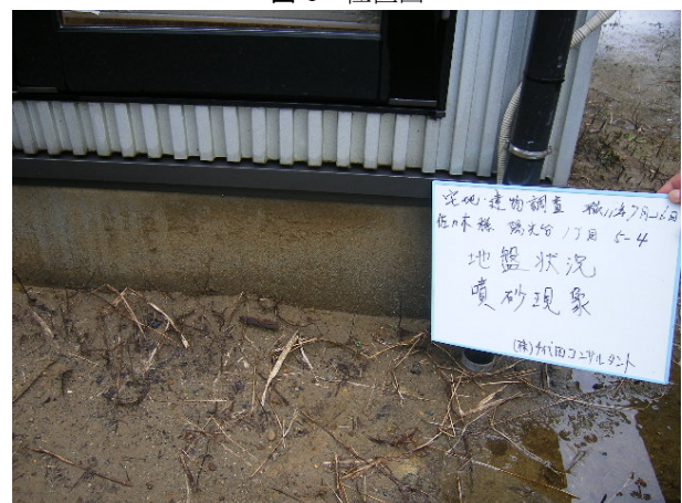
写真-1 2007 年新潟県中越沖地震による噴砂現象
