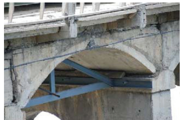
写真-12 アンガル材でトラスに応急補強された床版損傷部
