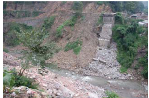
写真-13 倒壊した紅東大橋
