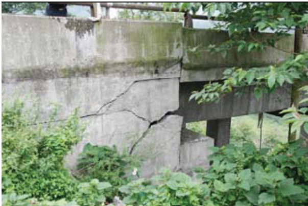
写真-3 主桁の衝突に伴う橋台の被害
