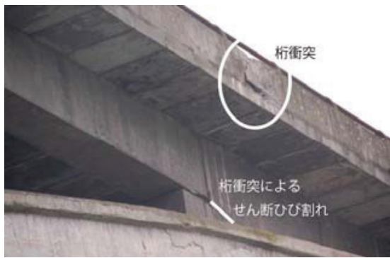
写真-5 アーチクラウン部の桁間衝突
