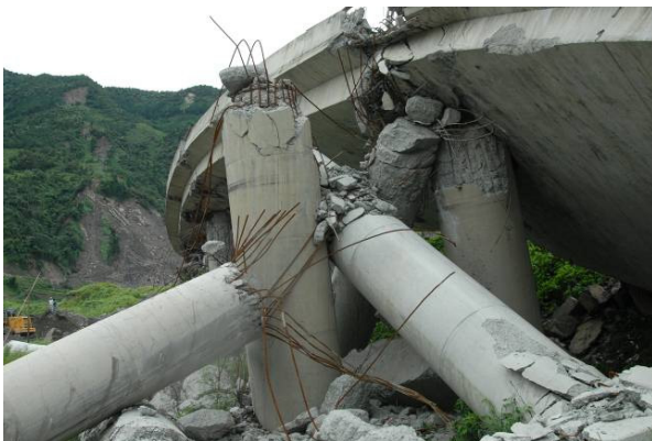
写真-7 落橋部の橋脚損傷状況 (P5 橋脚)
