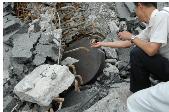
写真-3 落下したゴム支承
