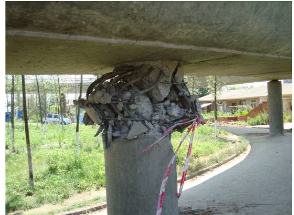
写真-12 P2 橋脚の被害と P3 橋脚
