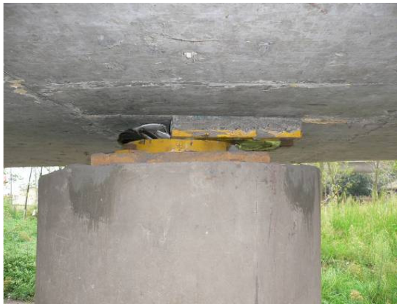
写真-15 P1 橋脚鋼製支承の橋軸方向変位
