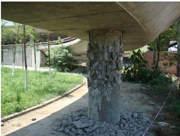
写真-16 橋脚のせん断破壊
