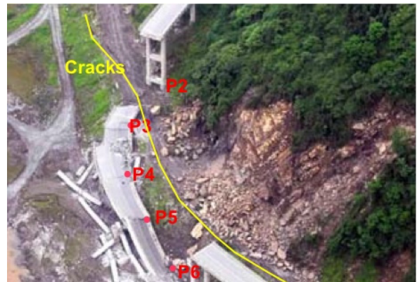
写真-2 地震直後の百花大橋落橋部 (ネット写真 (西南交通大学教授李亜東氏提供) に加筆)
