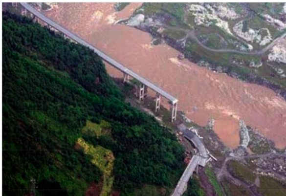
写真-1 落橋直後の百花大橋 (新華社による)
