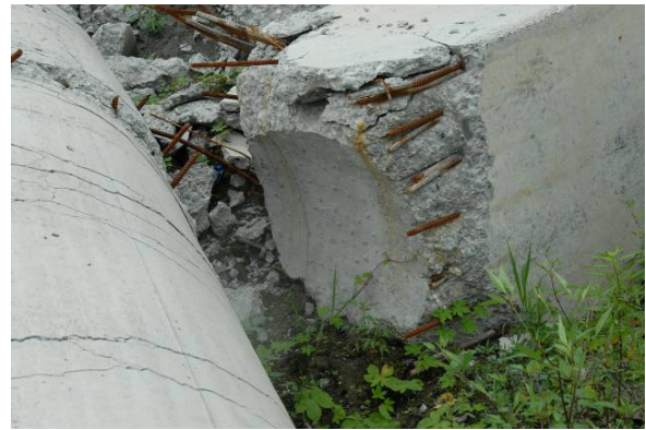
写真-8 橋脚と横梁接合部の分離 (P5 橋脚)
