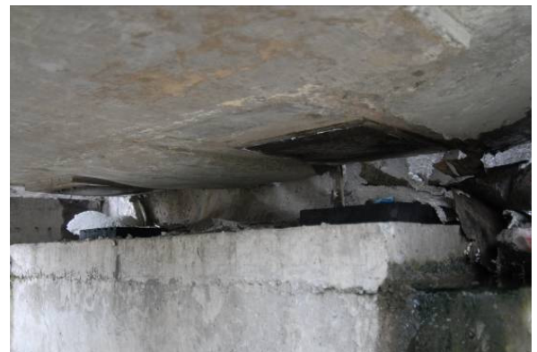
写真-14 A1 橋台部での桁の浮き上がり
