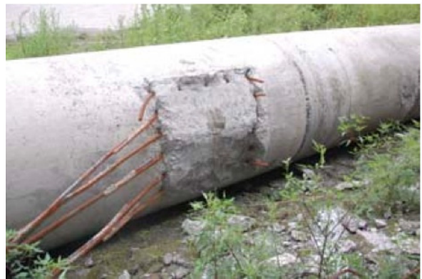
写真-9 横梁と結合されていた橋脚柱の固定部
