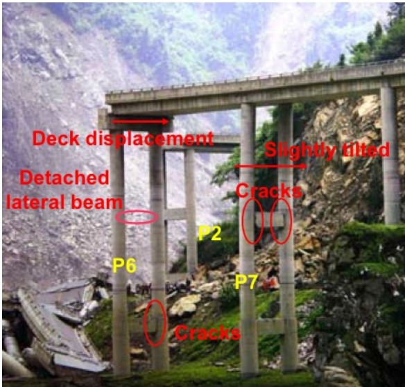
写真-6 P6, P7 橋脚の損傷と桁移動 (ネット写真 (西南交通大学教授李亜東氏提供) に加筆)
