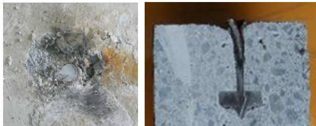
図-10 試験体II-1-4の損傷状況
