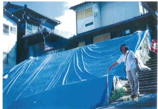
写真 2 西片山地区の崩壊した石積み擁壁 8)
