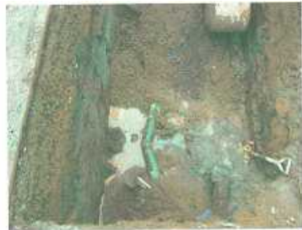
写真1 ガス導管の被害状況
