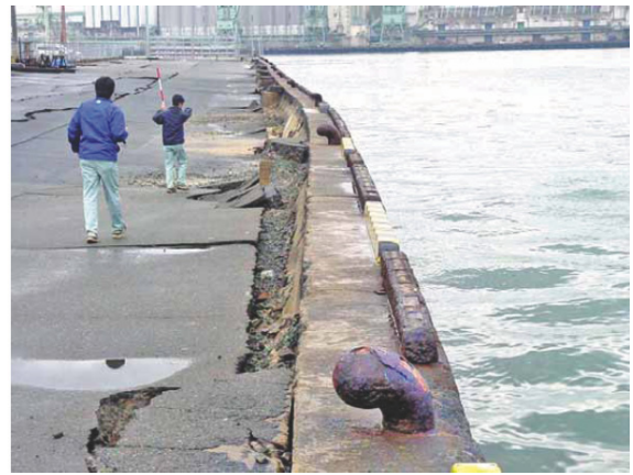
写真-1 福岡県西方沖地震時の護岸の流動化 (最大5.5m押し出されていた)
