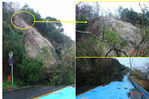
写真一1 弘地区の斜面表層崩壊および下方道路の沈下
