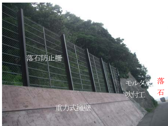
写真-7 落石地点より数十メートル付近に落石防止柵工
