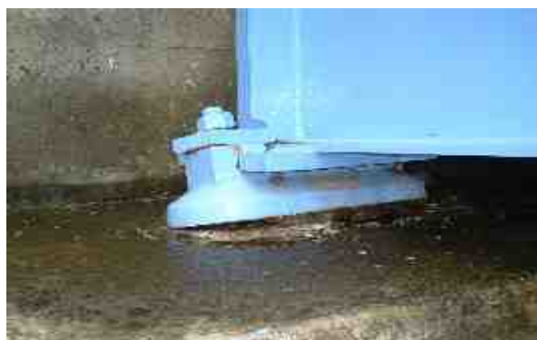
図-3 支承の破損状況
