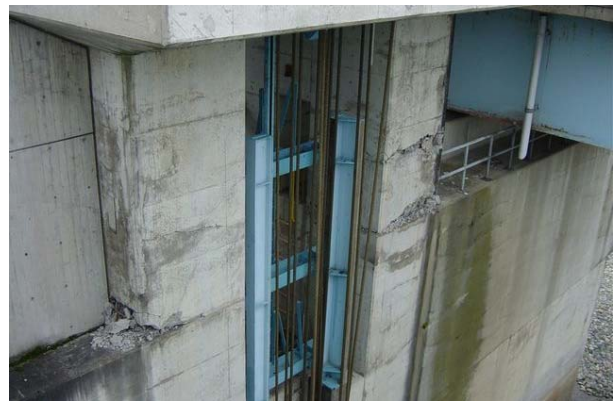
写真1 妙見堰の門柱被害 (H16 新潟県中越地震)
