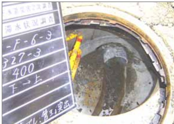
写真-1 管きょの突出被害の例 (開削工法のマンホール内に突き出した管の外周から地下水がにじみ出している)
