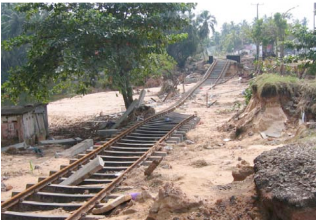
写真3 鉄道の基礎が侵食され大きな影響が生じた
