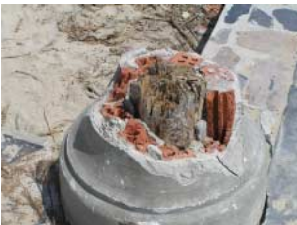
写真7 木筋コンクリートも弱い
