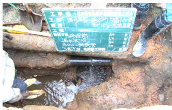
写真-1 折損状況
