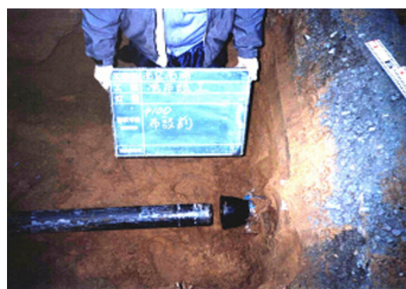
写真-2 継手部離脱状況
