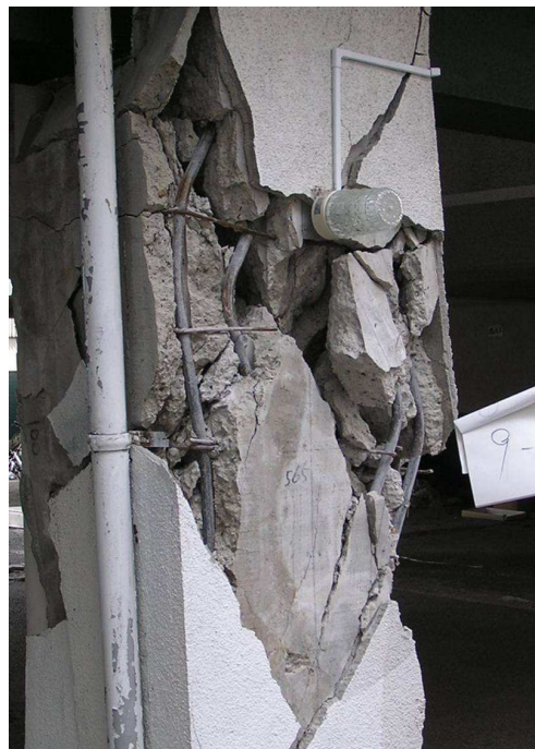
写真-1 柱のせん断損傷
