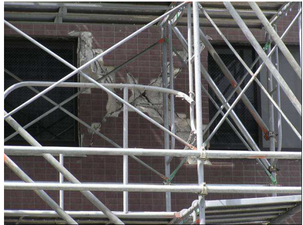
写真-2 壁の損傷
