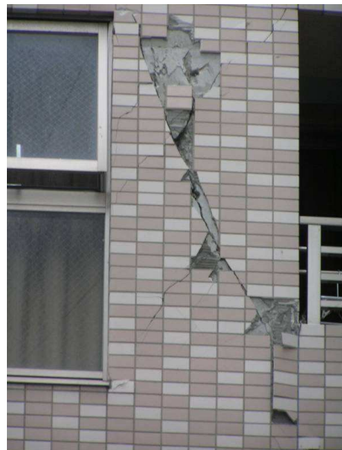
写真-3 柱の損傷
