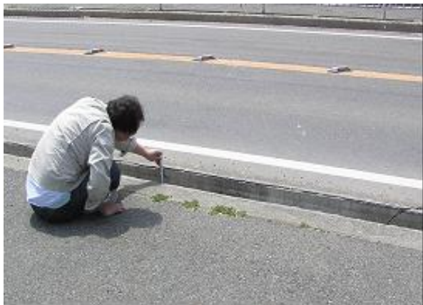
写真-4 桁の段差
