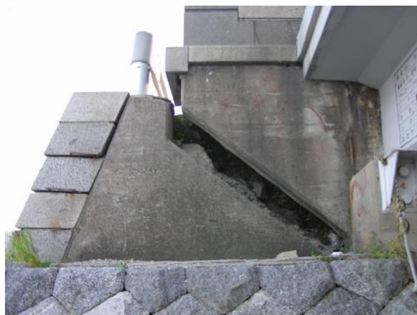
写真-2 周辺地盤の沈下による橋台のズレ
