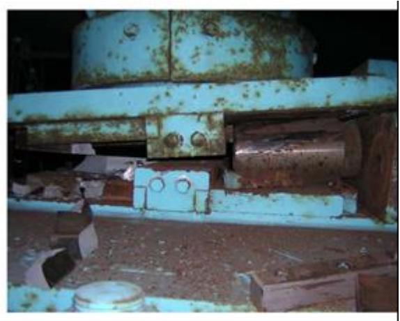
写真-6 ローラー欠落（上流側）
