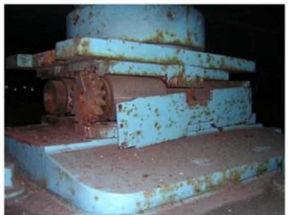
写真-7 サイドブロック損傷（下流）
