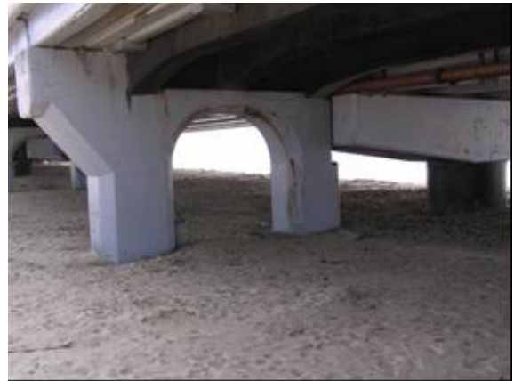
写真-5 橋脚のひび割れ
