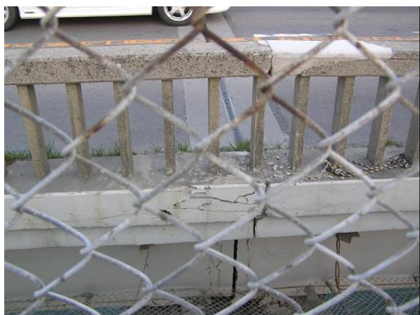
写真-1 桁の衝突による損傷 (第2径間と第3径間)
