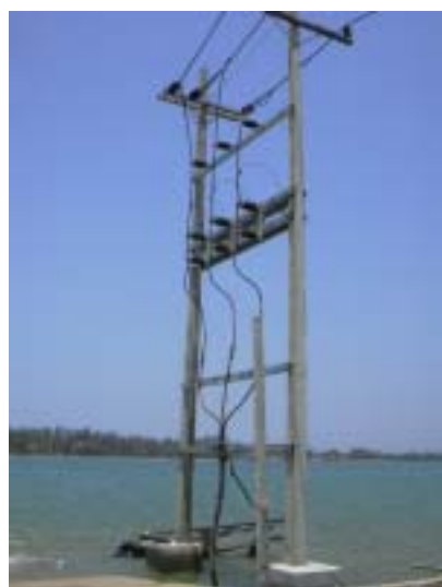
図-17 Kho Khao 島への送電側の電柱（再建後）
