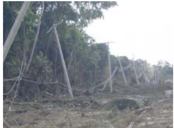
図-28 電柱の倒壊
