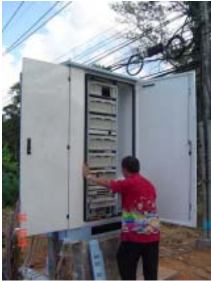
図-42 Bang la on での交換盤の設置状況
