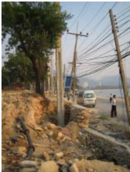
図-4 洗掘被害の様子
