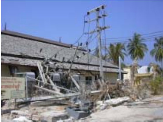
図-19 柱状変圧器の倒壊
