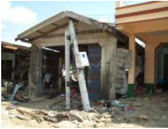
図-25 電柱の倒壊
