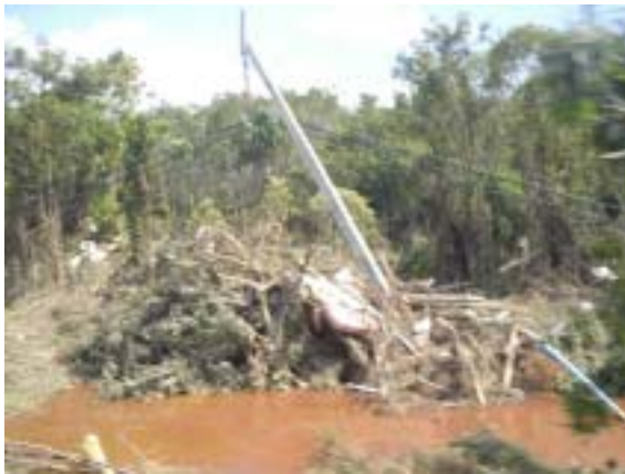
図-27 電柱の倒壊
