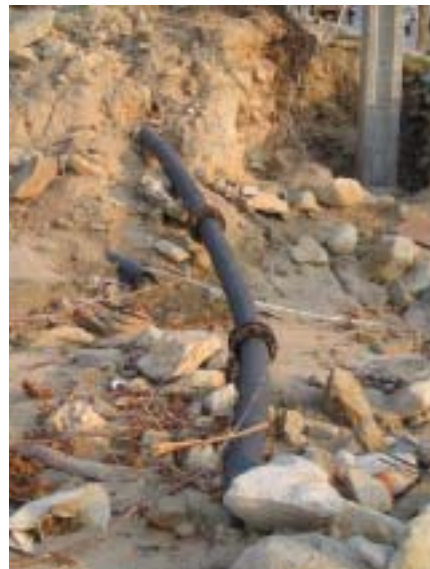
図-5 洗掘被害の様子
