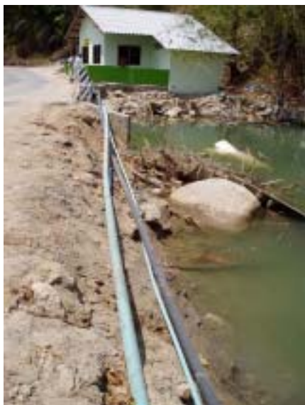
図-6 橋梁横の洗掘被害の様子
