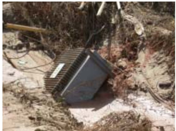
図-22 柱状変圧器の倒壊
