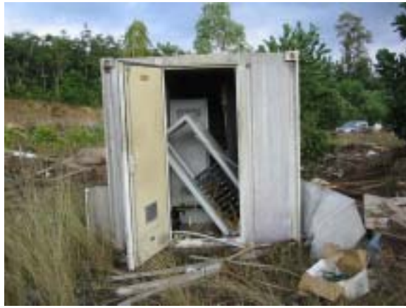
図-35 交換盤の被害
