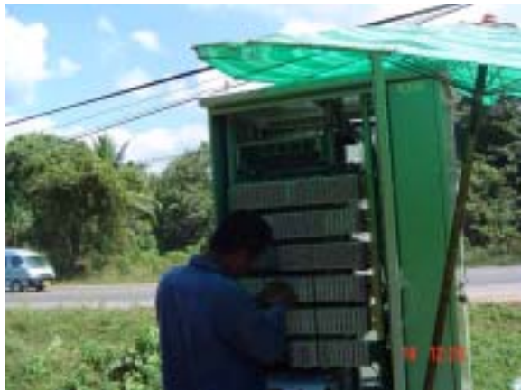
図-40 Pak Veep での交換盤の設置状況
