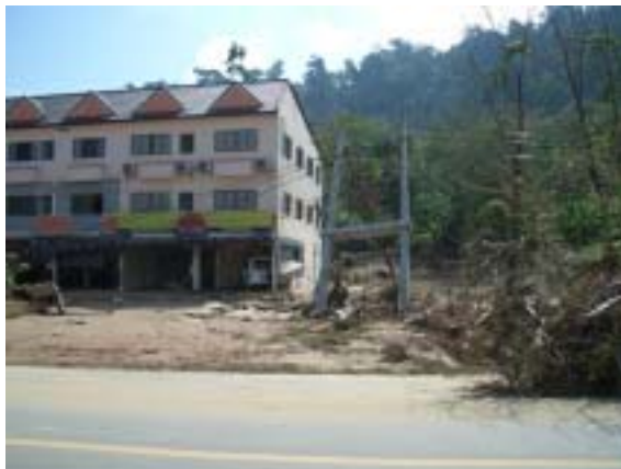
図-21 柱状変圧器の倒壊
