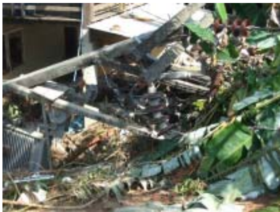
図-23 柱状変圧器の倒壊
