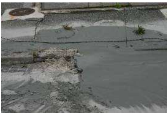
写真-4 荒津コスモ石油前で噴砂跡
