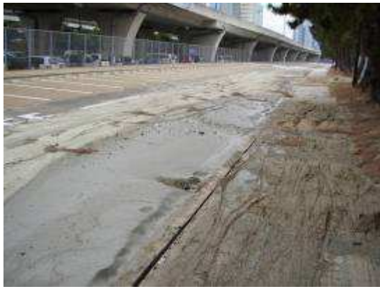
写真-3 ヤフードーム裏シーサイドももち海浜公園駐車場で噴砂跡
