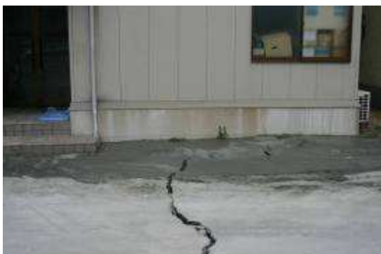
写真-6 中央埠頭7号岸壁の背後での噴砂跡
