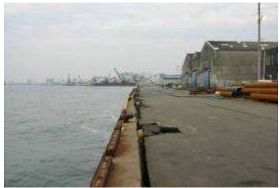
写真-13 中央埠頭 7 号岸壁の被害状況 (200/3/21 撮影)
