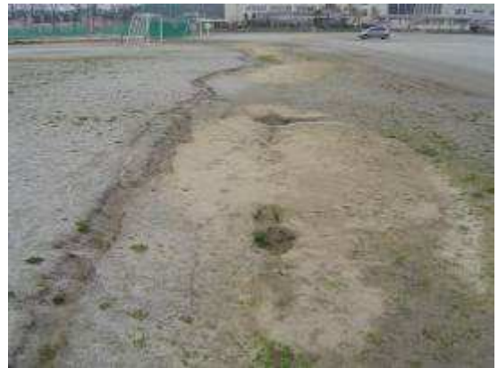
写真-9 志摩中学校グラウンドでの噴砂跡
