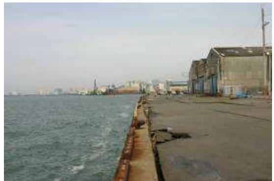
写真-14 中央埠頭 7 号岸壁の被害状況 (2005/3/26 撮影)
