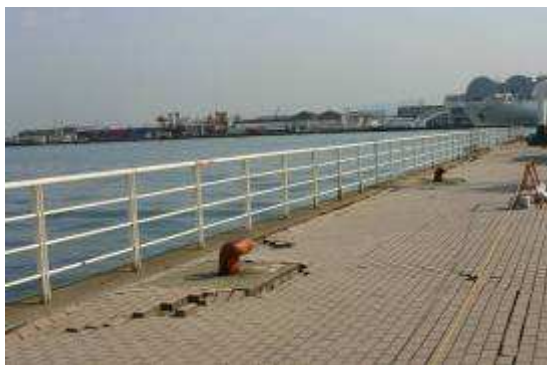
写真-19 博多埠頭先端部サンセットパークの被害状況
