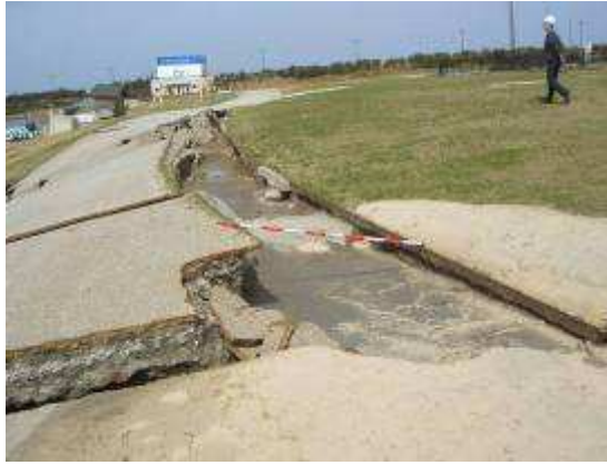
写真-23 海の中道海浜公園（光と風の広場）内での地盤の流動
