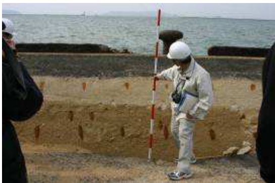
写真-12 中央埠頭 7 号岸壁の被害状況
