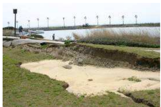
写真-8 海の中道公園内での噴砂跡
