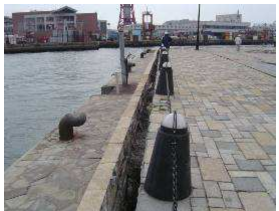
写真-15 中央埠頭イントバースの被害状況
