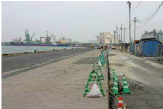
写真-18 箱崎埠頭 6 号岸壁の被害状況
