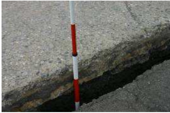
写真-17 箱崎埠頭 6 号岸壁の段差
