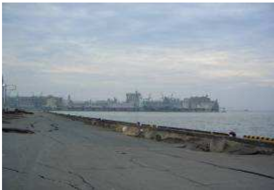
写真-11 中央埠頭 7 号岸壁の被害状況
