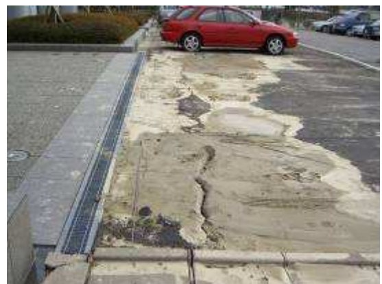
写真-1 百道浜 RKB 会館駐車場での噴砂跡
