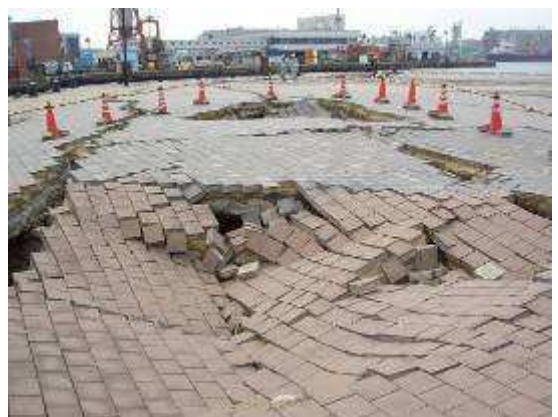
写真-16 中央埠頭イベントバースの被害状況
