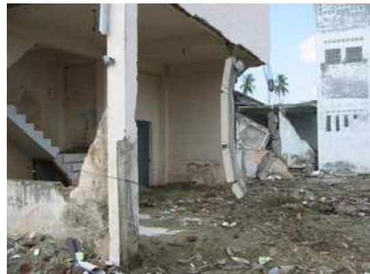
図-7 中央部分が折れ曲がる被害を受けている柱（地区 F 東側の沿岸部にて）
