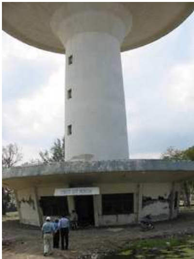
図-5 基部に曲げによるひびが見られる給水塔
