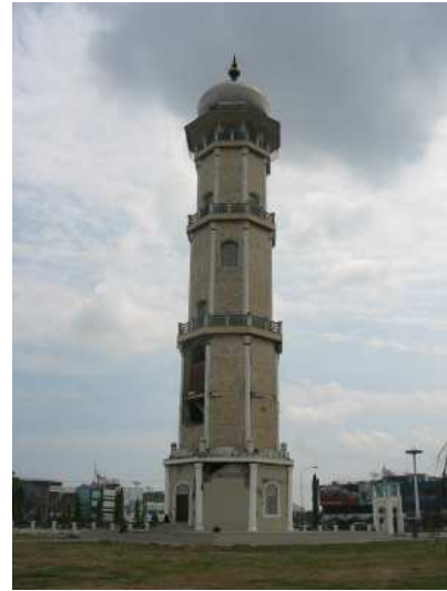
図-6 グランドモスク前の塔は損傷を受けている
