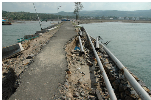
図-7 石油積み下ろし基地のパイプライン盛土の被害(Malahayati)
