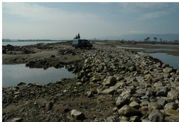
図-5 堤体が崩壊した河川堤防(Aceh 分水左岸)
