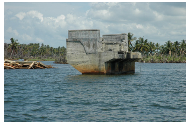
図-11 落橋したトラス橋の右岸側橋脚(Kuala Bubon)
