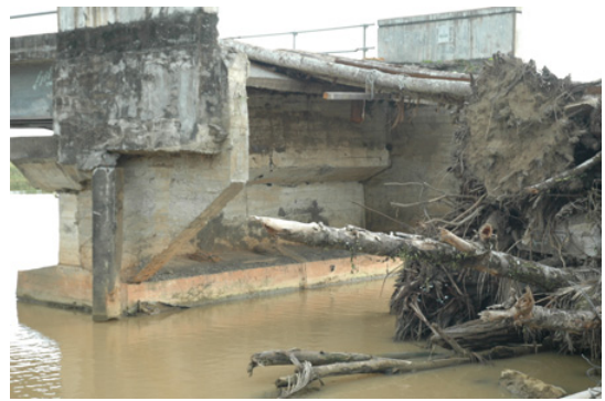
図-13 取付け盛土の流失(Kuala Tadu)
