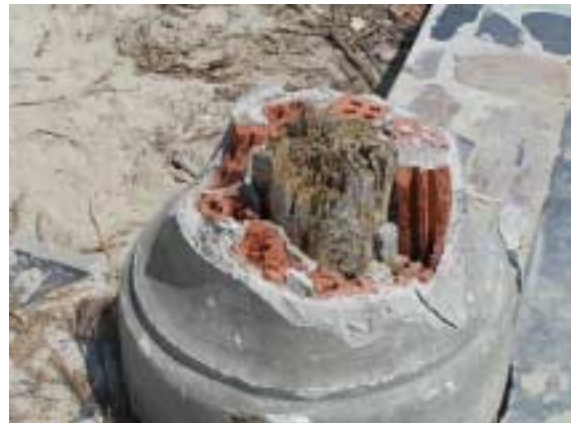
写真4 タイ・カオラックの津波によって折れた建物柱は、木の周りをレンガコンクリートで固めた複雑なものだった。
