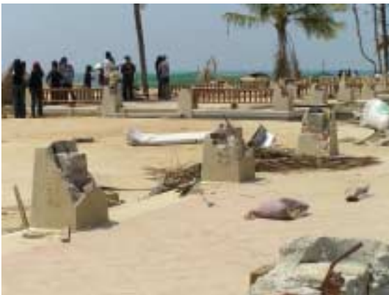
写真3 タイ・カオラックの津波によって折れた鉄筋コンクリート柱の鉄筋は柱中心に僅か1本のみ。
