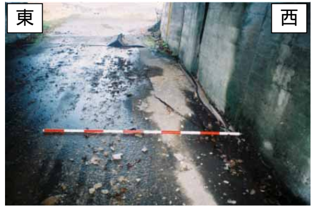
写真-4 木沢隧道における西側側壁の変形及び路盤の圧縮
