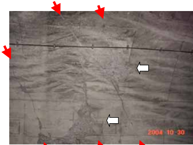
写真-1 斜め円周方向の亀裂と亀裂周辺のコンクリート剥落（北口から180 m地点の東側側壁、矢印は亀裂の写真上両端を白矢印は剥落部を示す）
