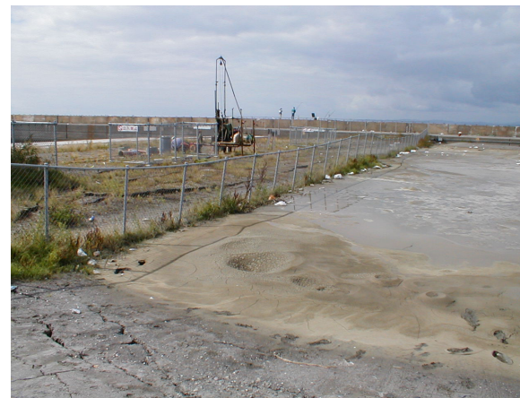
写真-2 試験岸壁背面の噴砂および地盤変状 2003年9月30日 試験岸壁背面から
