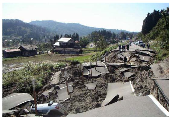
写真-1 片盛構造の盛土の天端崩壊の事例 3) (国道117号小千谷市細島地先)
