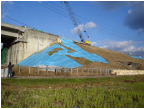
写真-3 橋梁の取り付け盛土の沈下の事例 (関越自動車道芋川橋左岸)
