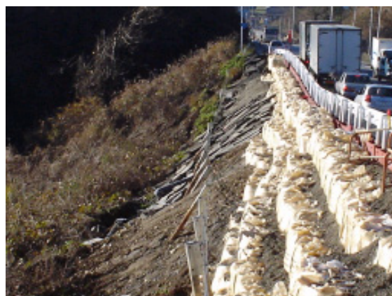
写真-2 両盛構造の盛土ののり面崩壊・沈下の事例 (国道117号小千谷市細島地先)
