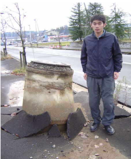
写真-1 新潟県中越地震における小千谷市でのマンホールの浮上り状況
