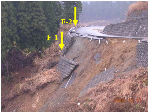
図-5 調査地点 F-1, F-2 における被害状況と簡易貫入試験の実施位置
