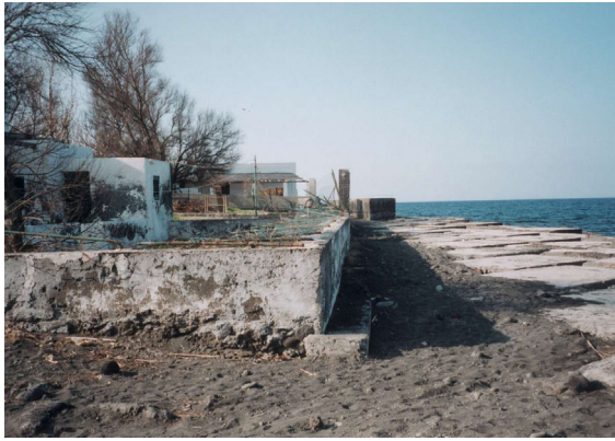
図-5 津波に倒されたフェンス (Pta.Lena, 2003 年 3 月 20 日撮影)
