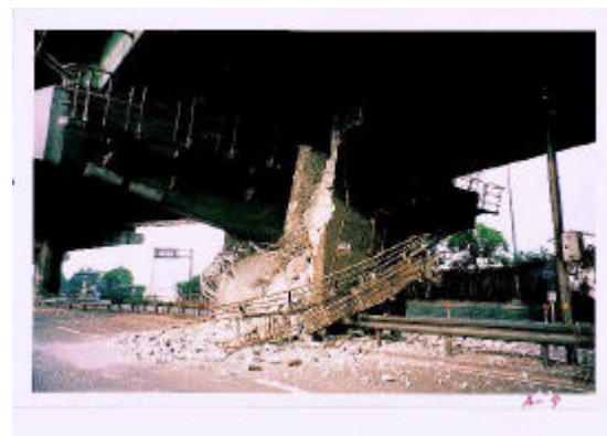
写真 4.4-2 せん断被災の一例
