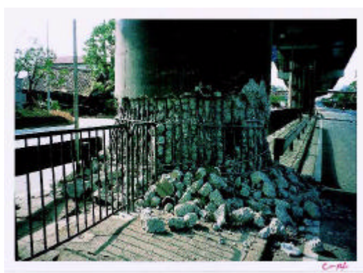
写真 4.4-1 曲げ被災の一例
