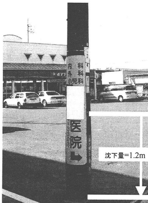
写真-2 配電柱の沈下 (米子市旗ヶ崎)
