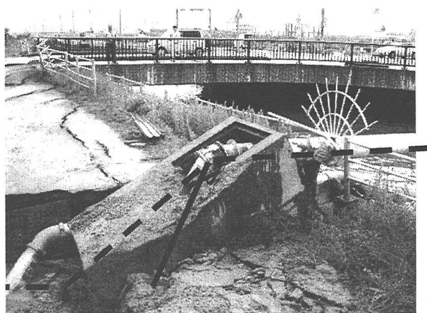
写真-4 水管橋取付部分の転倒によって生じた損壊(写真提供：米子市水道局)
