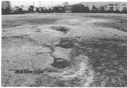
写真-1 グラウンドに生じた噴砂（広島市中区）
