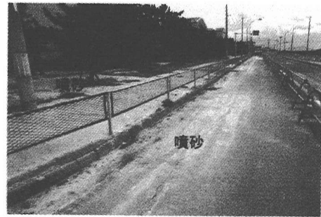
写真-2 道路脇の噴砂（廿日市市木材港臨港道路）
