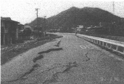
写真-3 河川堤防の被害（三原市宗郷町）
