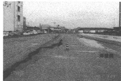
写真-4 エプロン部の亀裂（草津港）
