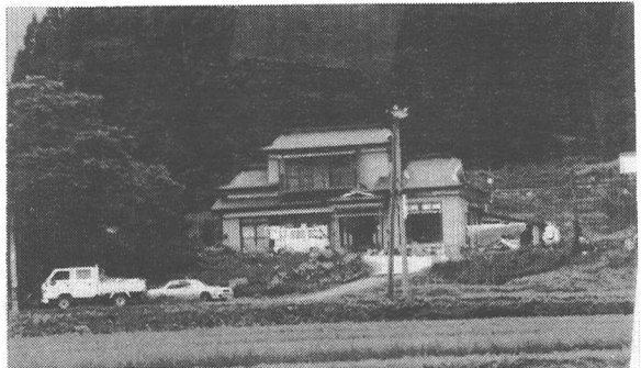
家屋の半壊（峠付近）
