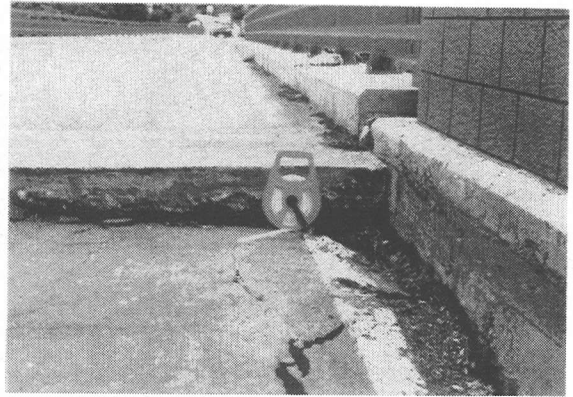
アプローチの沈下（国道 108 号線中沢橋）
