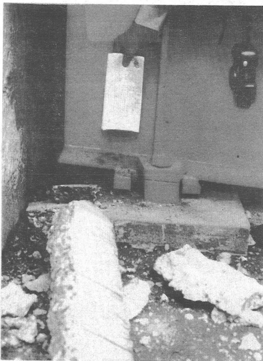
橋台と支承の被害（国道 108 号線中沢橋）
