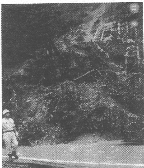
斜面崩落（旧仙秋ライン片倉森付近）
