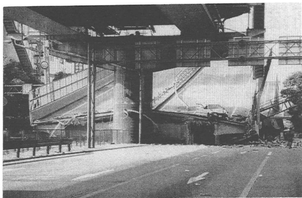
写真1 橋桁S3およびS4の落橋
