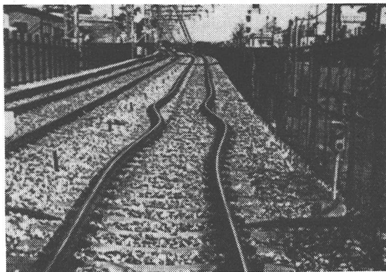
写真1 1995年兵庫県南部地震(M7.2)での例
