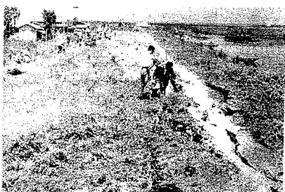
P-11 阿賀野川左岸 (堤防のキレツト沈下)
