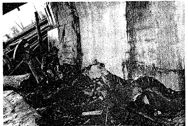
P-4 八千代橋橋脚の破壊 (局地的地すべりによる大破壊)
