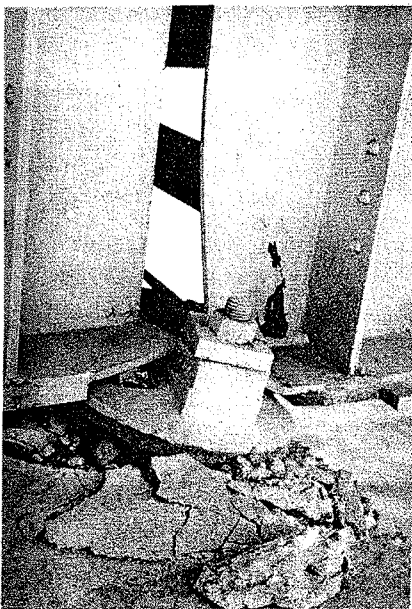
P-5 八千代橋省とフランジ の破壊
