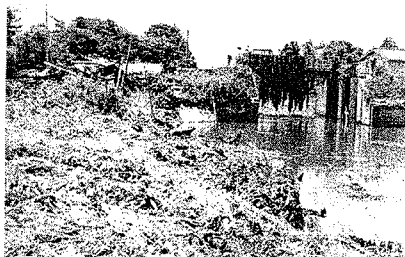
P-12 阿賀野川左岸通船川水門 (堤防の沈下)
