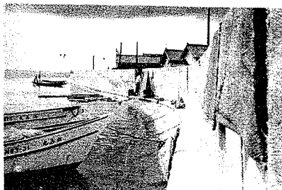
P-13 阿賀野川右岸 (パラペットの破壊)
