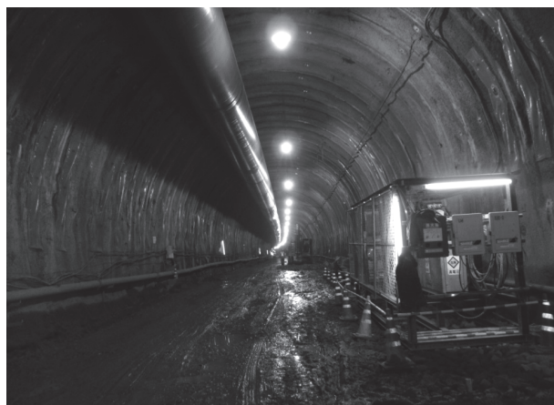
写真-7 トンネル内の状況（壁面・底面とも湿潤状態）
