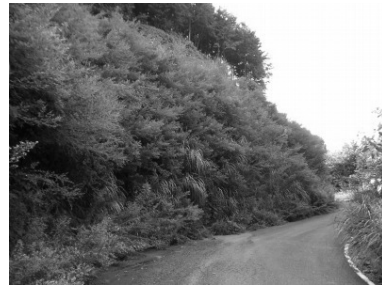
写真-7 林道後山新田線の樹林化
