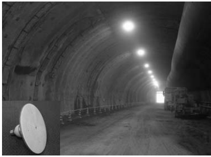
写真3 坑内LED照明の使用状況
