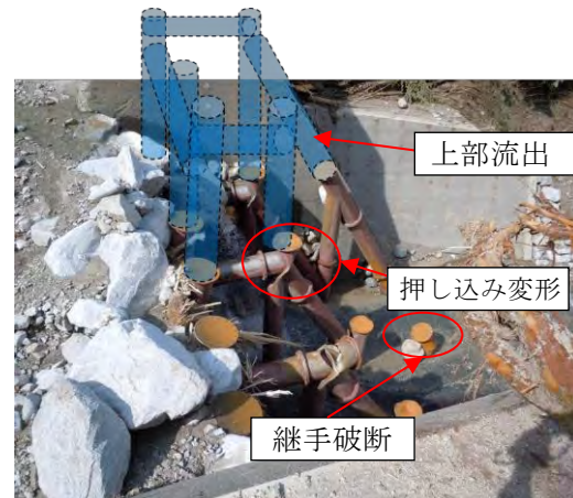
写真-1 被災後の梨子沢第 1 砂防堰堤
